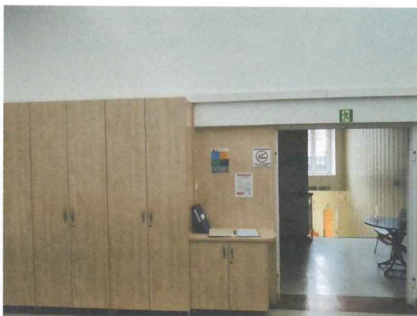
Fotografia 9. Szafy zlokalizowane w korytarzu w poziomie piętra, w tle łatwozapalne okładziny ścian na drodze ewakuacyjnej
