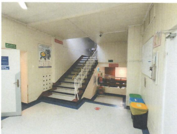
Fotografia 1. Łatwo zapalne okładziny ścian i sufitu na drodze ewakuacyjnej w poziomie parteru
