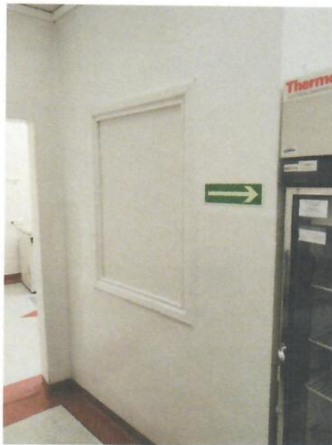
Fotografia 3. Bezklasowy otwór w ścianie stanowiącej obudowę drogi ewakuacyjnej w poziomie piętra
